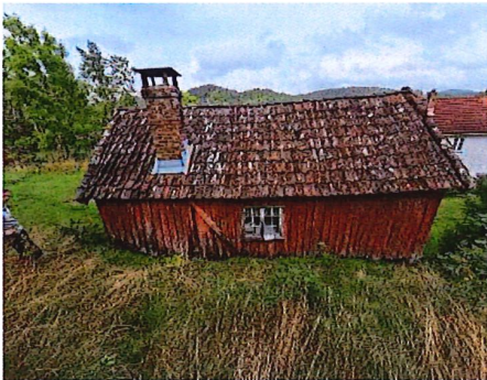
Langvegg mot vest i dårlig forfatning.
