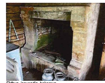
Eldhus, innvendig, bakerovn
