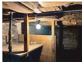
Bolig, lav, fuktig kjeller under kjøkkenet
